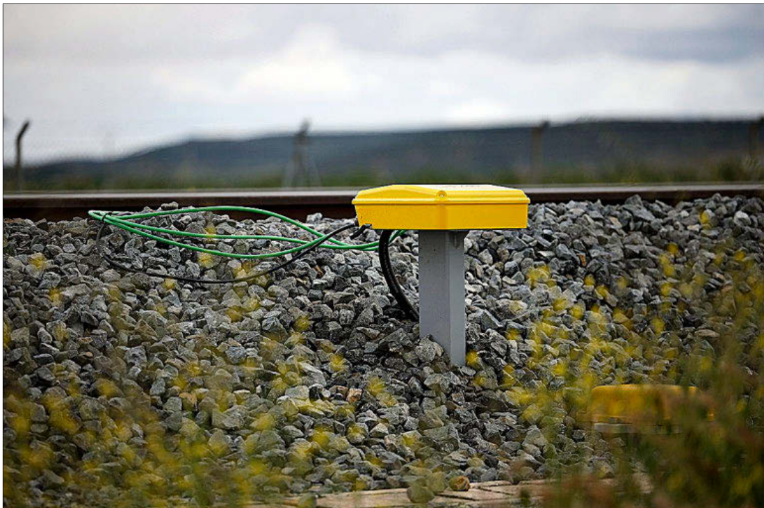
Caja de control de señalización afectada por la sustracción de cable. ALBERTO DI LOLLI
